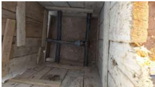
Raccordement au réseau de l'ONEP
